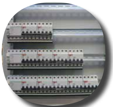
Les composants électriques sont installés.
