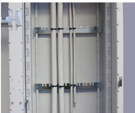
Ledninger fastholdes med kabelbindere.
