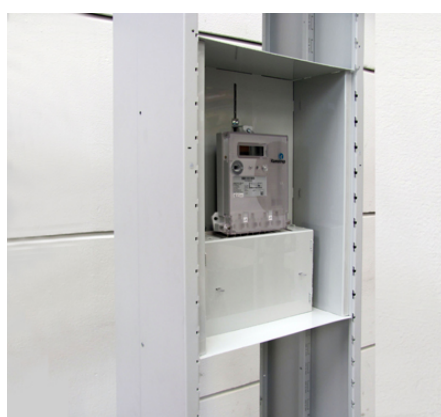
Der afdækkes, og der kan monteres måler og plombering.
