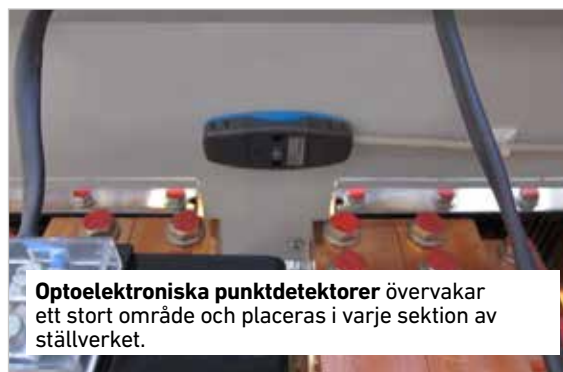
Fiberoptiska detektorer installeras för att detektera ljusbågsfel vid alla spänningsförande delar i en kopplingsutrustning där en ljusbåge kan förväntas uppstå.
