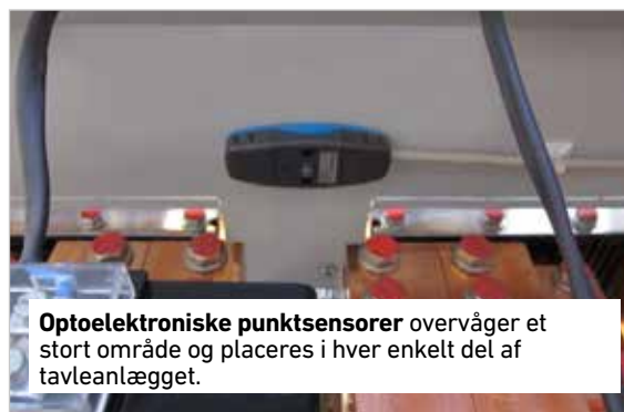
Fiberoptiske sensorer er installeret for at detektere lysbuefejl ved alle spændingsførende dele i et koblingsanlæg, hvor lysbuefejl kan opstå.
